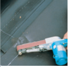
Abschleifen nach Bewitterung
